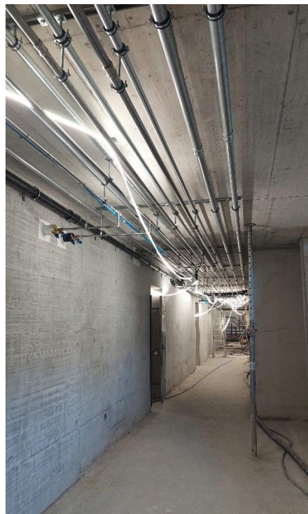
Leitungen UG Decke
