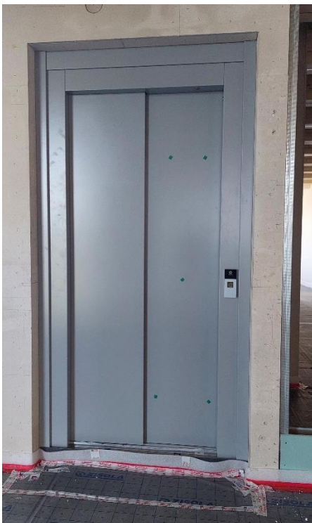
Lift bereits eingebaut
