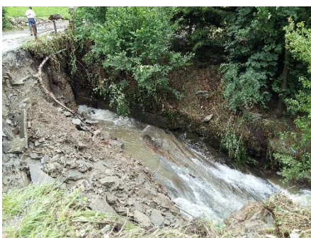
Unwetterschäden Brücke Oberdierikon
